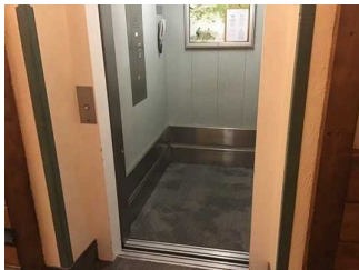
Aufzug Heidehaus –zu Zimmer 209 im 2. OG–
