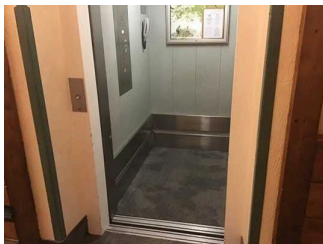
Aufzug Heidehaus –zu Zimmer 209 im 2. OG–
