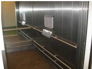
Aufzugskabine und die horizontal angeordneten Bedienelemente
