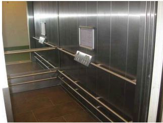
Aufzugskabine und die horizontal angeordneten Bedienelemente
