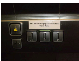
Bedienelemente Fahrsstuhl Eingangsbereich zum WC (UG)
