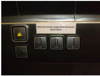
Bedienelemente Fahrstuhl Eingangsbereich zum WC (UG)
