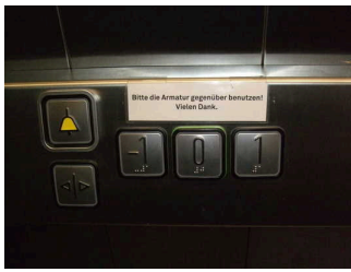
Bedienelemente Fahrstuhl Eingangsbereich zum WC (UG)
