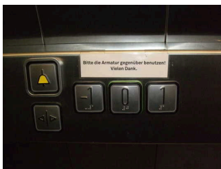
Bedienelemente Fahrstuhl Eingangsbereich zum WC (UG)
