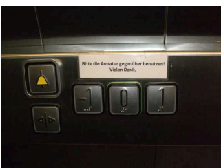
Bedienelemente Fahrstuhl Eingangsbereich zum WC (UG)
