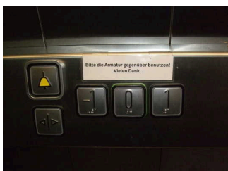
Bedienelemente Fahrstuhl Eingangsbereich zum WC (UG)
