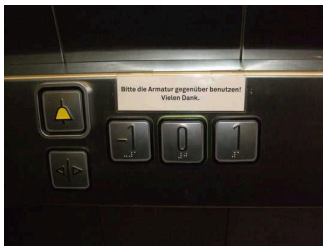
Bedienelemente Fahrstuhl Eingangsbereich zum WC (UG)
