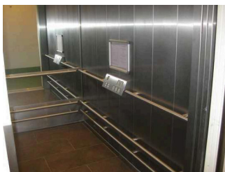
Aufzugskabine und die horizontal angeordneten Bedienelemente
