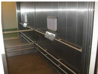
Aufzugskabine und die horizontal angeordneten Bedienelemente
