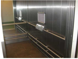
Aufzugskabine und die horizontal angeordneten Bedienelemente
