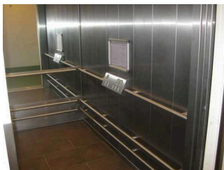
Aufzugkabine und die horizontal angeordneten Bedienelemente
