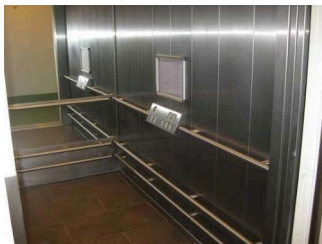
Aufzugskabine und die horizontal angeordneten Bedienelemente
